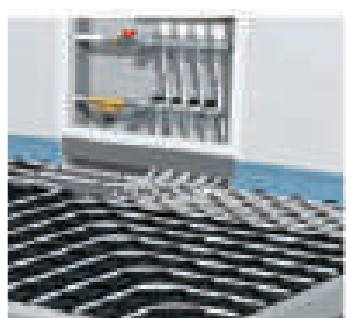
Рис. 2. Примеры применения шкафов SCC
