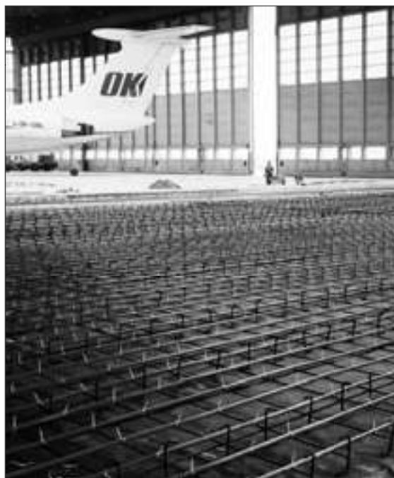
Напольное отопление для промышленных зданий
