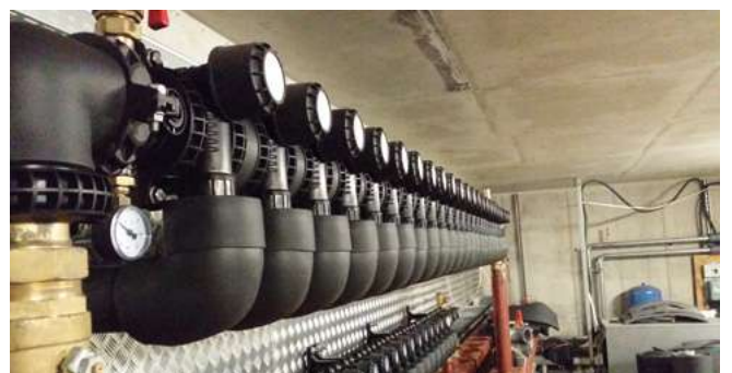
Фотография показывает коллектор ProCalida GT3 27-контурный в системе грунтового теплообменника теплового насоса. Система находится в торговом центре Huta в местечке Węgierska Górkа (Южная Польша).
