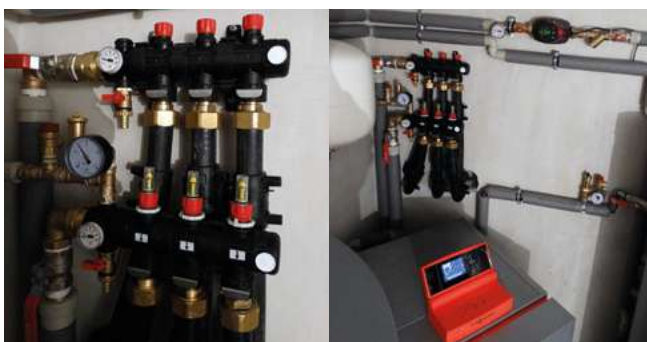
Фотографии показывают коллектор ProCalida IN 3-контурный в системе теплового насоса. Система находится в коттедже в местечке Turza Śląska (Южная Польша).
